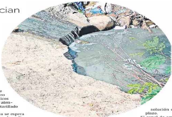
El bote de aguas negras en el barrio Montevideo 2 se encuentra expuesto en una de las vías principales del sector. / Foto cortesía: La Opinión.
